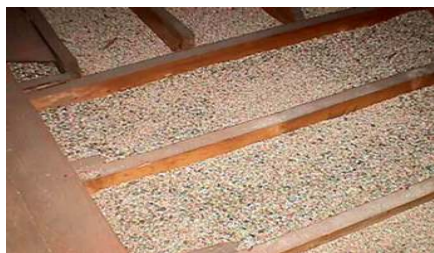
Aislante de vermiculita entre vigas en el ático
